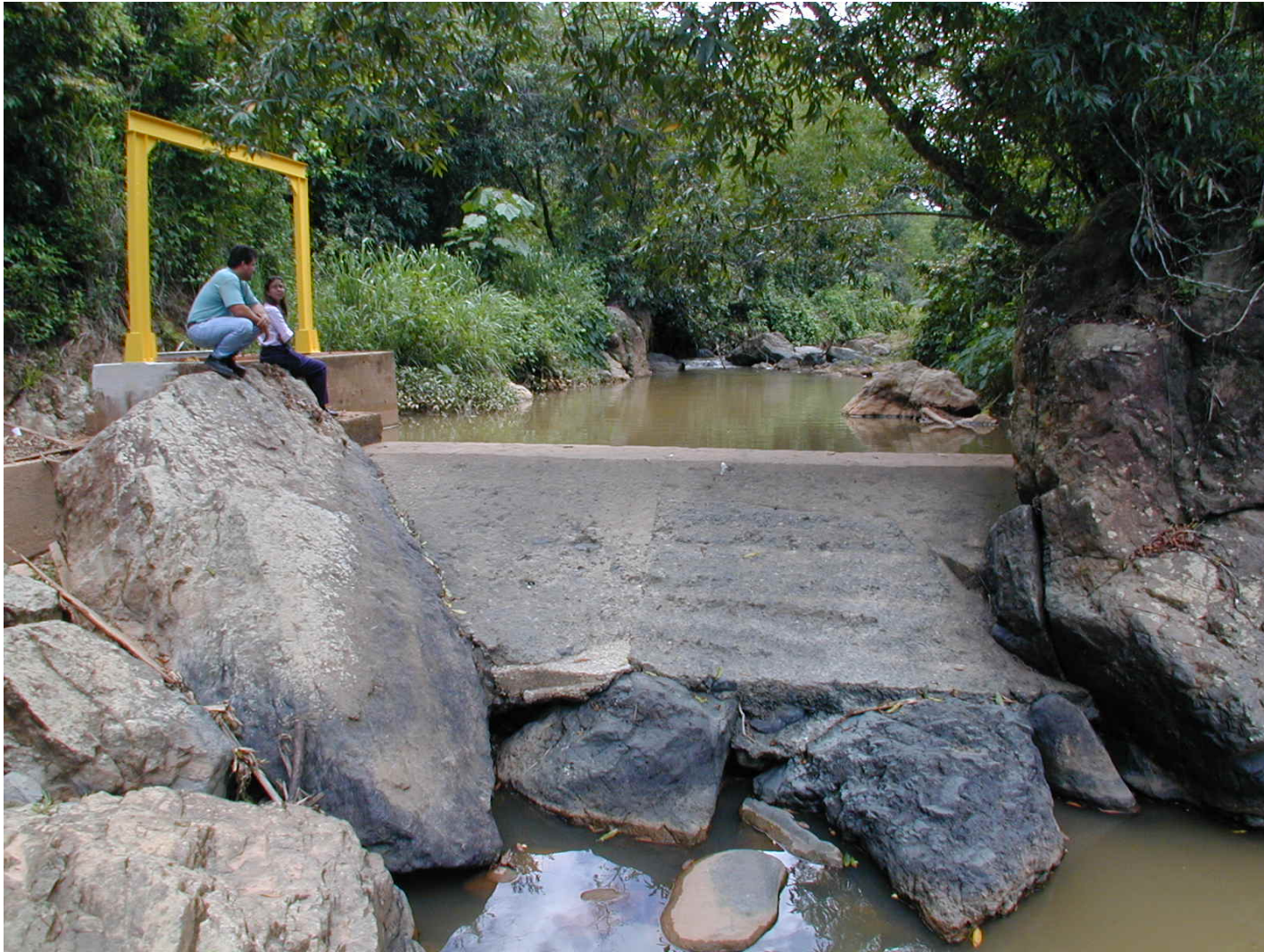
Río Cañas gravity intake, Miradero FP, Mayagüez.
