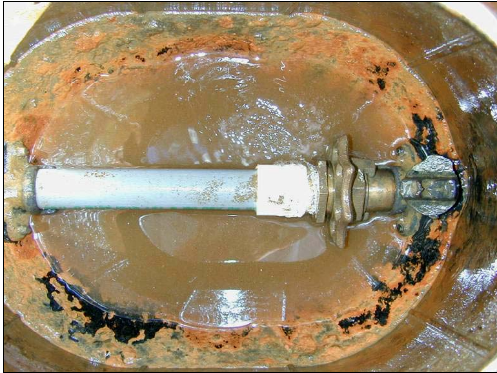
Ilustración 6.19 Muestra de un “pillo de agua” instalado
